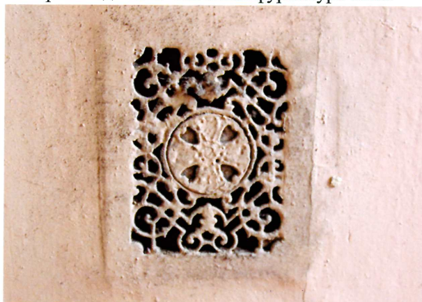
Видовая точка № 69. Жилой корпус. Прямоугольная вентиляционная решетка.
